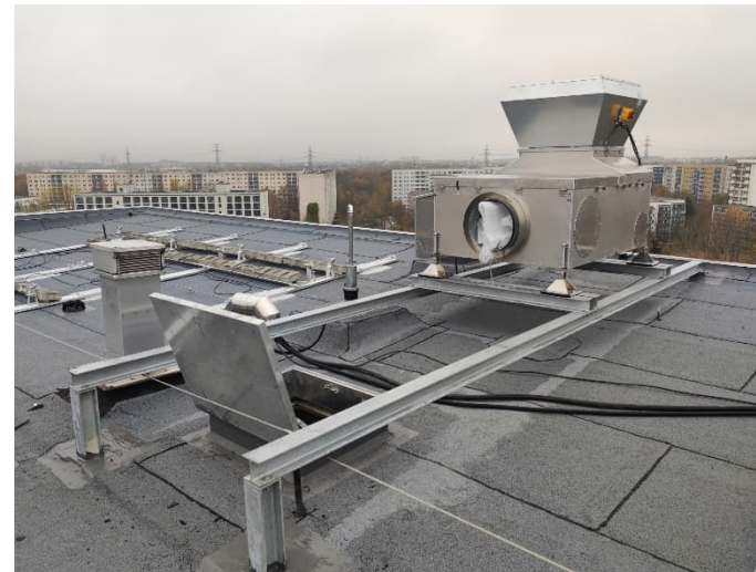
Beispielfoto: Abluft-Wärmepumpe auf dem Dach
